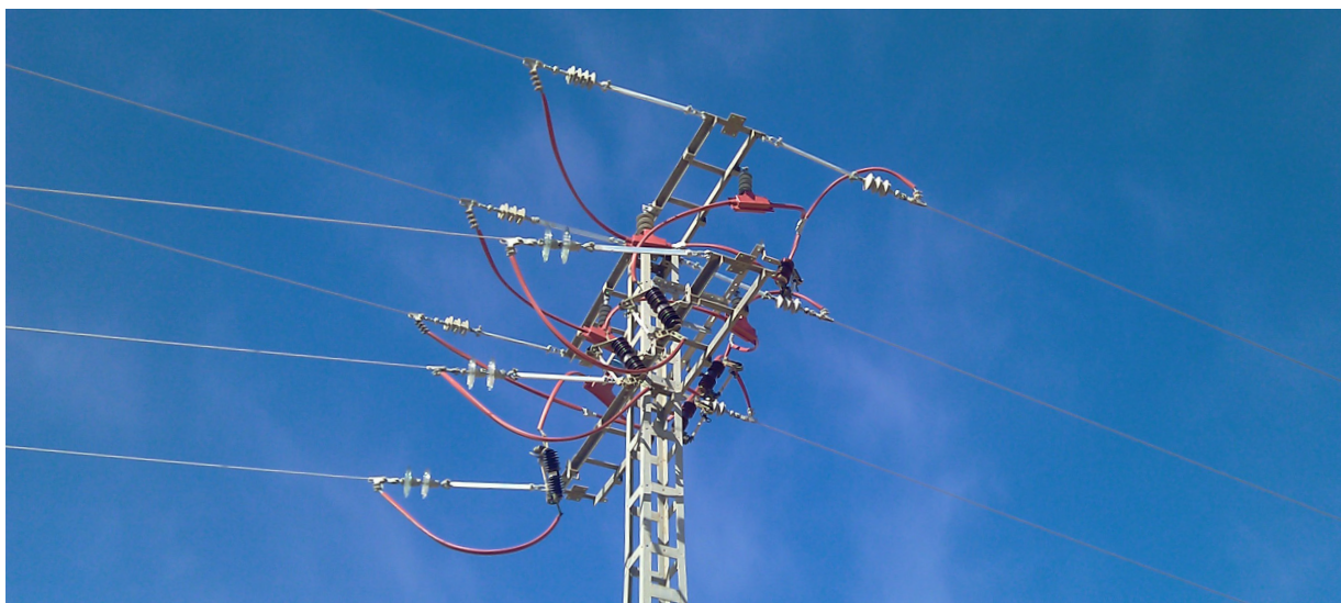
Torre eléctrica de alta tensión.
