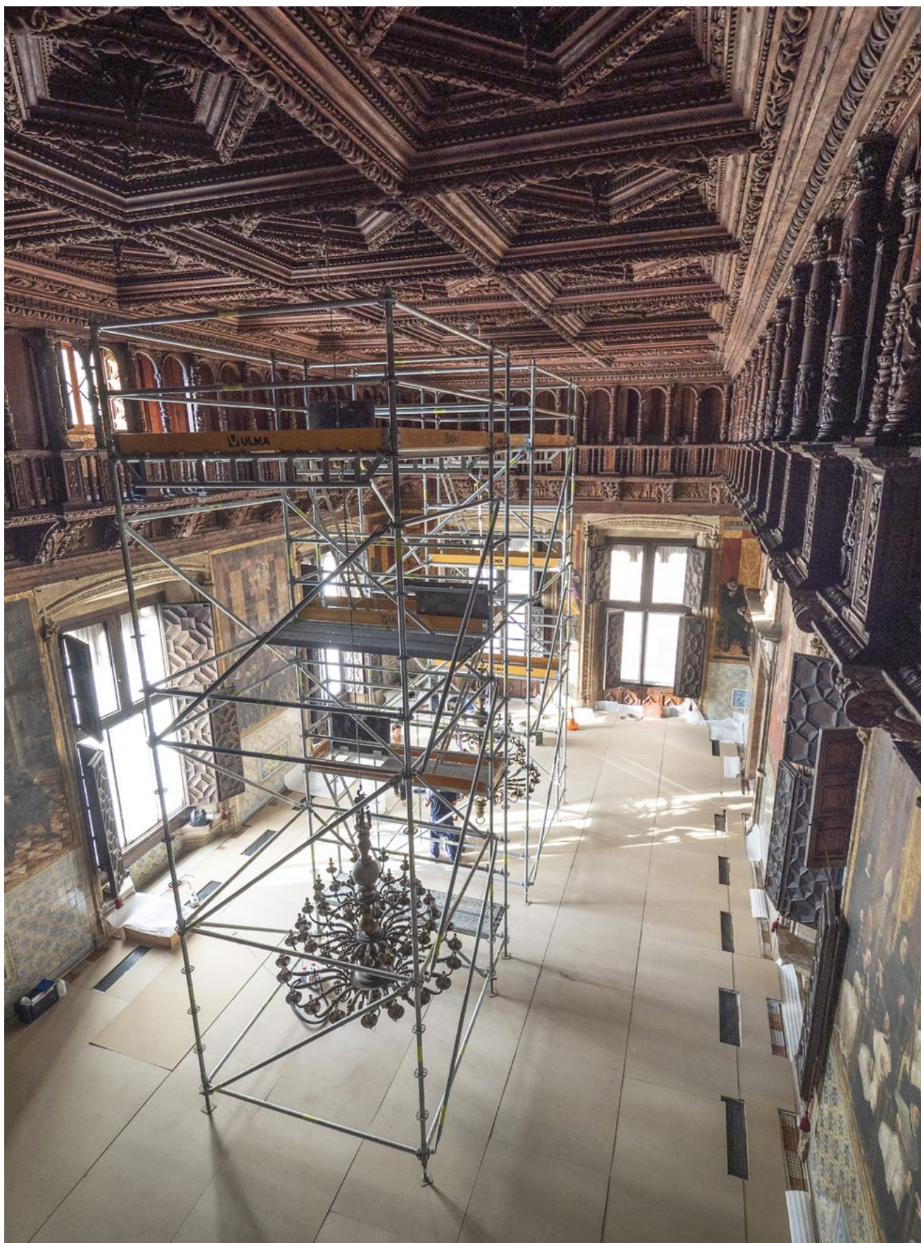
Actuación de mejora de la iluminación de la Sala Nova del Palau de Generalitat Valenciana.
